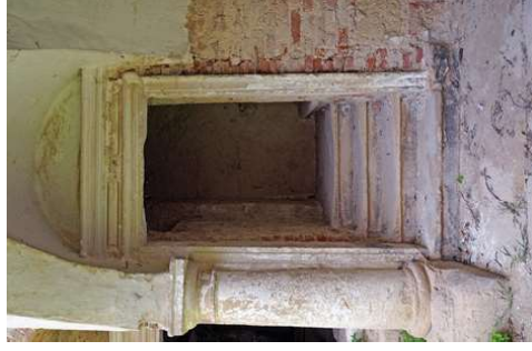
03-7.2.49 Kamnit portal – rozeta, v tem primeru zelo poškodovana, kos 2/1
